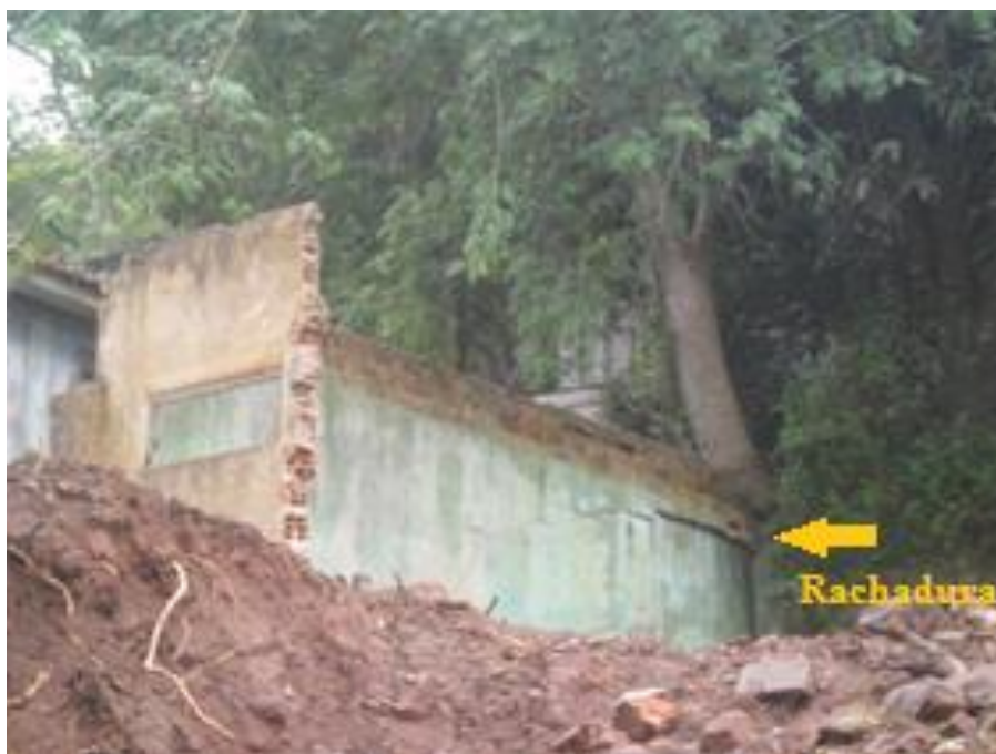
Figura 5 - Ruínas de uma residência após a ação de movimentos de massa e pressão da vegetação tortuosa proveniente de processos de escorregamento provocando rachaduras. Foto: COSTA, Tarcísio Oliveira, 29/05/2013.
