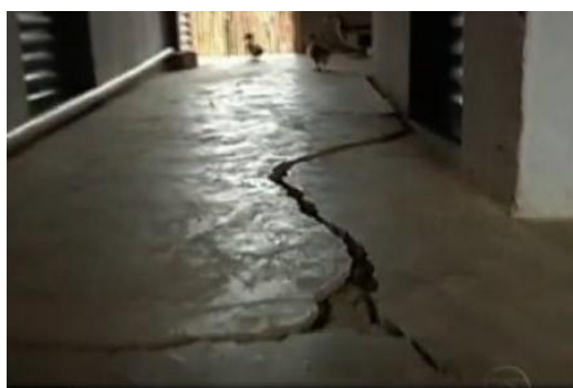
Figura 05: Rachaduras das casas no loteamento Monte cristo
